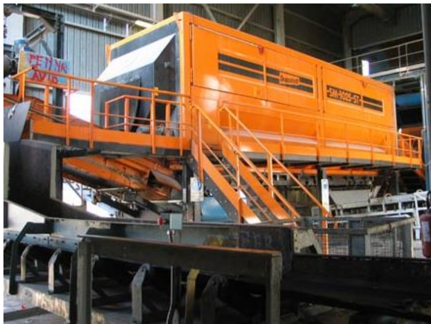
Figura 92– Dettaglio impianto di Cermec di Massa.
